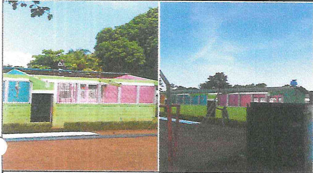
Foto1: Inicio de trabajos en el cambio de la estructura por costaneras de metal y lamina troquelada galvanizada
